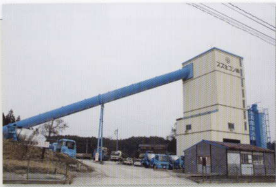
珠洲市内にある生コンクリート製造プラント。中央に見える傾斜した円筒がオーテックスの製品だ
